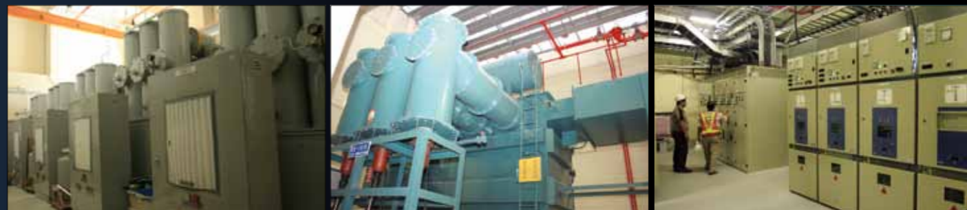
由左而右分別是負責輸送電力的主變電站、變壓器及控制設備。
