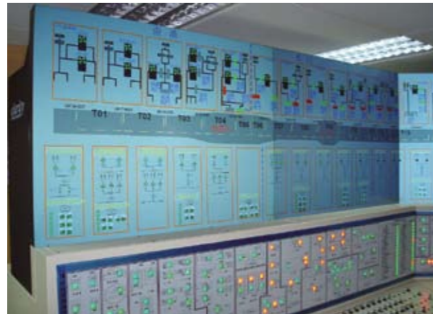
▲位於台北車站四樓的控制室是隧道中央監控系統的樞紐。
