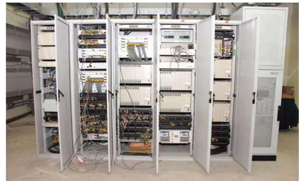
▲內湖機廠通信設備室。
